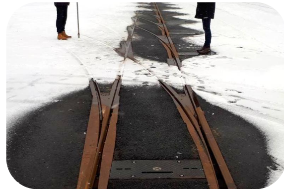
vytápění tramvajových výměn
